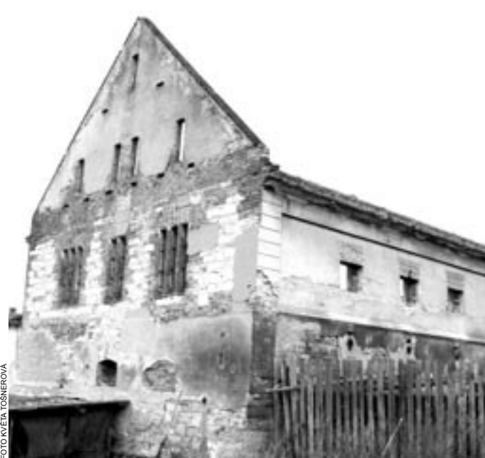
Hospodářský areál v Sýrovcích hrozí samovolným zřícením.
