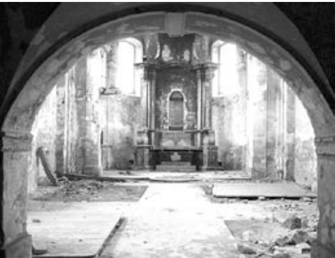
Kostel má být zakonzervován v polorozpadlém stavu.
