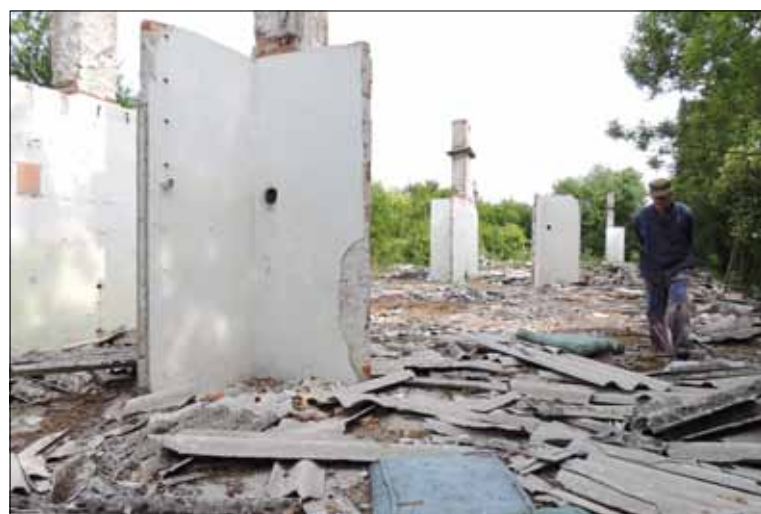
Ubytovna po útoku zlodějů a vandalů.
